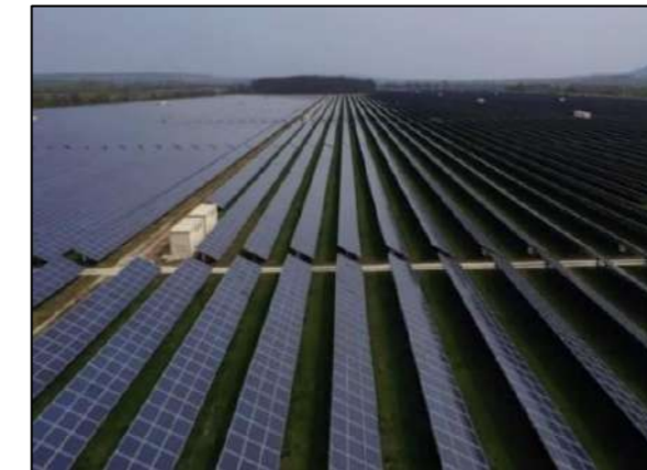
Figure 7 : Photographie du parc photovoltaïque "Karad" – Bulgarie (Source : RP GLOBAL)
